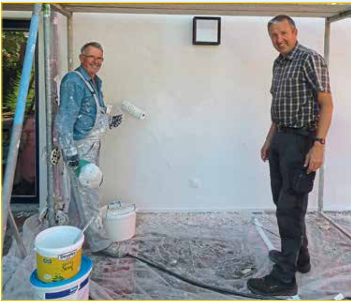
Im Bild Alfred Kipfelsberger mit Hans Götze, der die neu verputzte Außenfassade bei heißen Sommertemperaturen mühsam gestrichen hat.
