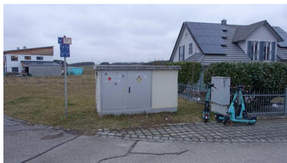
Trafostation auf Flurnummer 2740/15
